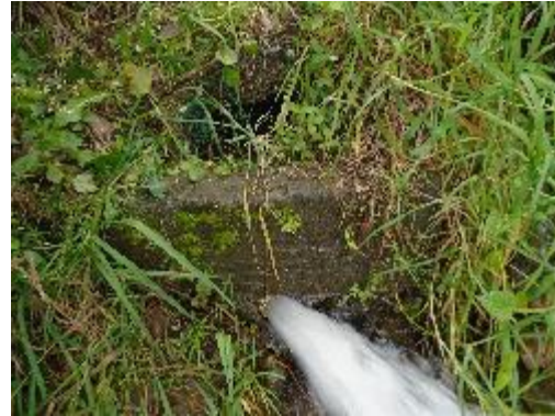
Fotografía 46. Válvula de purga 3
