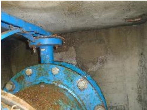
Fotografía 25. Válvula de corte (mariposa)
