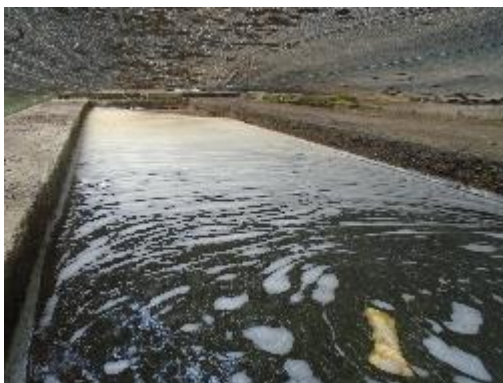
Fotografía 17. Desarenados zona de sedimentación
