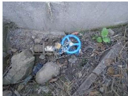
Fotografía 44. Válvula de purga 2
