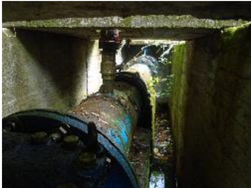
Fotografía 31. Caja de protección
