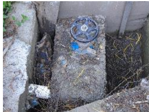
Fotografía 48. Válvula de purga 4
