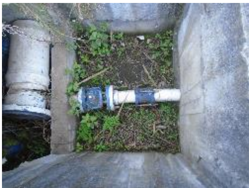
Fotografía 41. Vista Válvula de Purga
