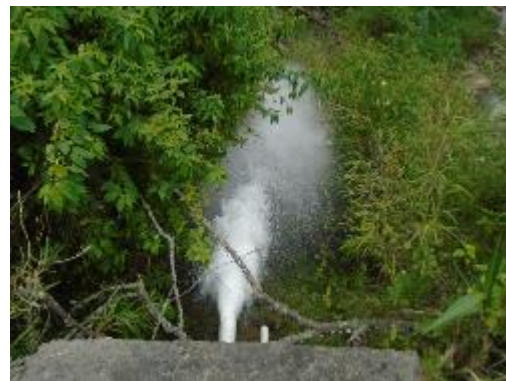
Fotografía 42. Válvula de purga 1 (Conducción)
