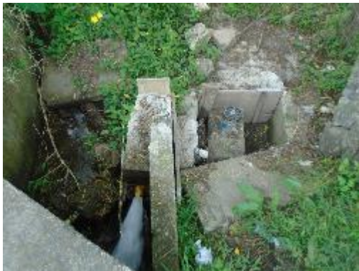
Fotografía 47. Válvula de purga 4
