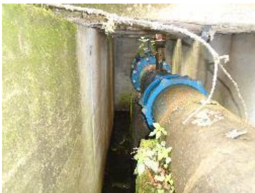
Fotografía 27. Válvula de aire
