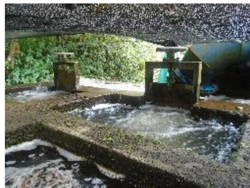
Fotografía 18. Desarenados zona de sedimentación
