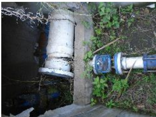
Fotografía 43. Válvula de purga 1 (Conducción)
