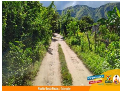
Antes de la construcción de la placa huella en la Junta de Acción Comunal de la vereda San Lorenzo en Girardot.
