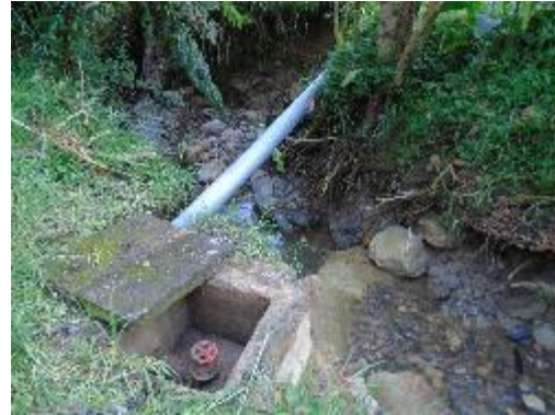
Fotografía 15. Vista Válvula de Purga
