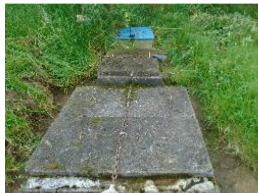
Fotografía 19. Vista Cámara de Quiebre
