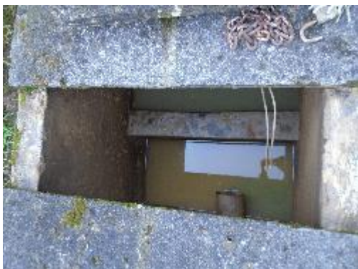
Fotografía 18. Vista lateral Cámara de Quiebre
