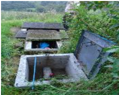
Fotografía 16. Vista Cámara de Quiebre
