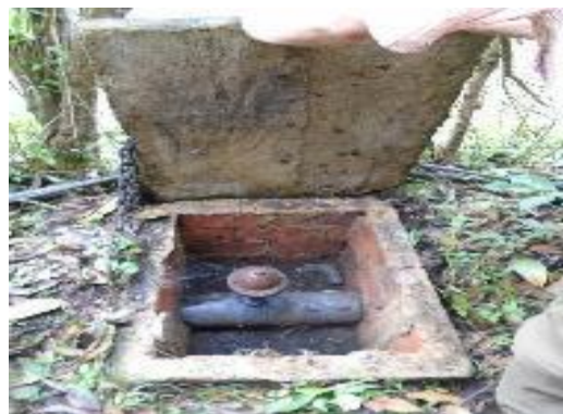
Fotografía 12. Vista Válvula de Aire
