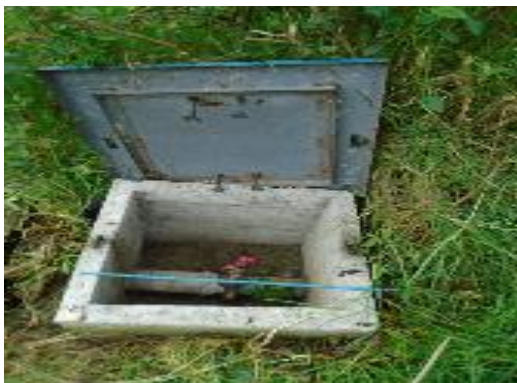
Fotografía 10. Vista Válvula de Aire
