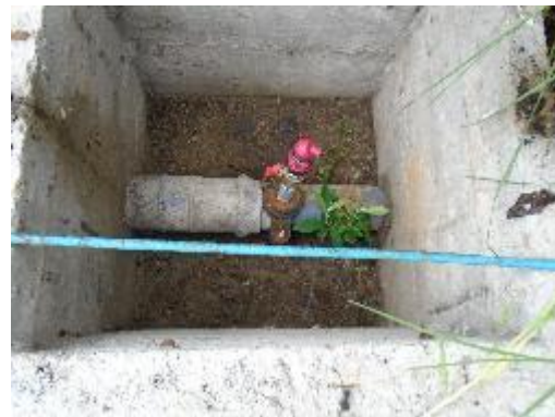
Fotografía 11. Vista Válvula de Aire
