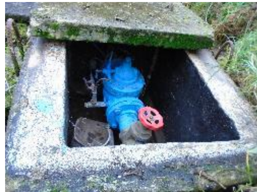
Fotografía 17. Vista Cámara de Quiebre
