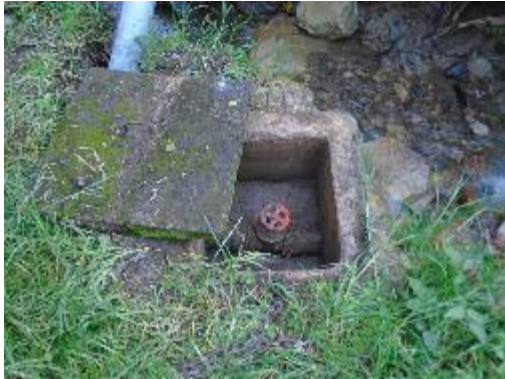
Fotografía 14. Vista Válvula de Purga
