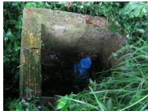
Fotografía 23. Válvula de corte HF 3"
