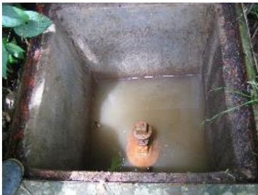
Fotografía 22. Válvula de corte HF 4" Inundada
