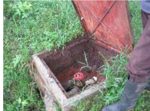
Fotografía 19. Válvula de purga 3"
