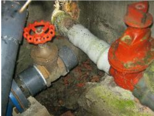
Fotografía 18. Válvula de purga 4"
