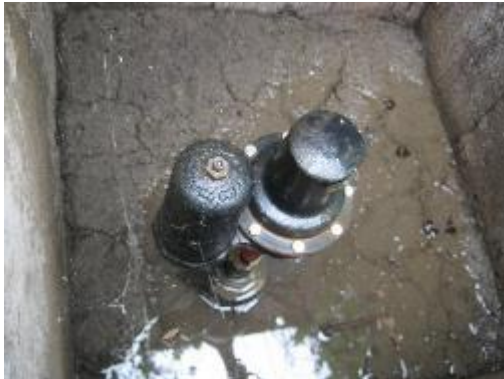
Fotografía 20. Válvula de aire 1"
