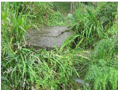
Fotografía 26. Cámara de Quiebre 4”
