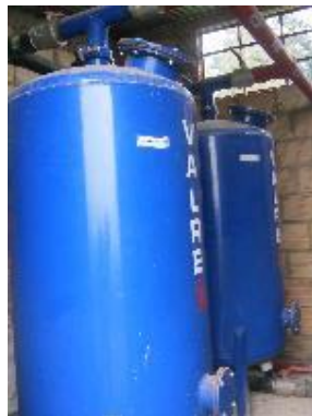
Fotografía 29. Filtros de Arena.
