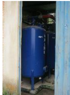
Fotografía 28. Estación de filtrado.
