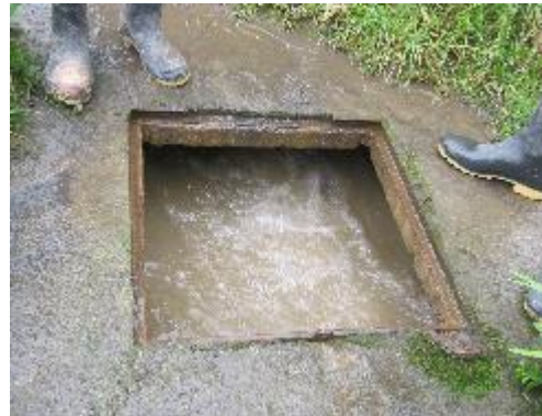
Fotografía 25. Cámara de Quiebre 4”
