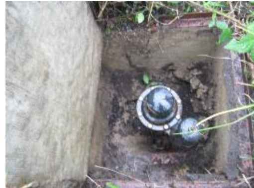
Fotografía 21. Válvula de aire 1"
