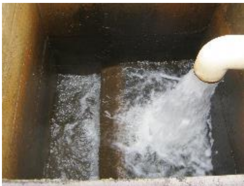
Fotografía 23. Cámara de Perdida de Presión de la C.Q
