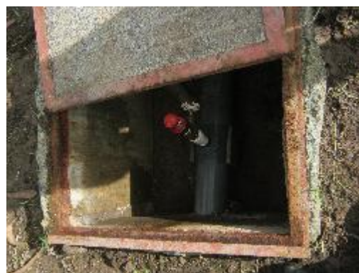
Fotografía 20. Válvula de Aire
