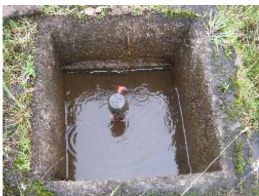
Fotografía 17. Válvula de aire
