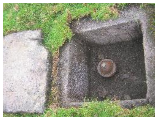
Fotografía 18. Válvula de aire
