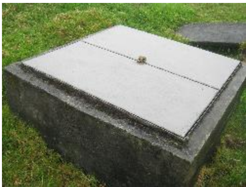
Fotografía 21. Cámara de Quiebre
