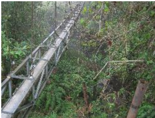
Fotografía 25. Paso Elevado # 1 tubería de PVC
