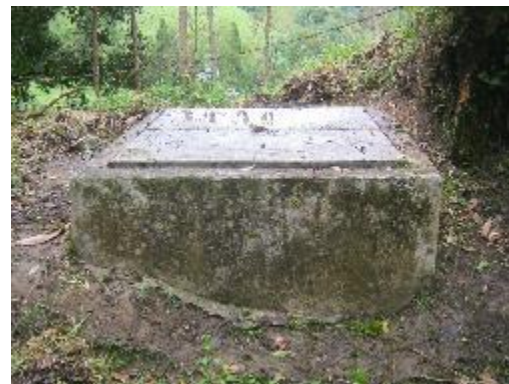
Fotografía 24. Cámara de Quiebre
