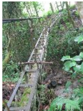
Fotografía 28. Paso Elevado # 4 tubería de PVC
