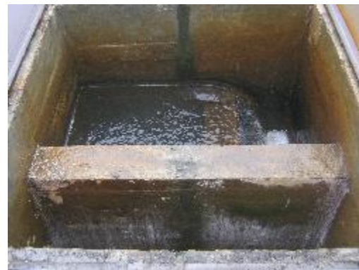
Fotografía 22. Cámara de Perdida de Presión de la C.Q
