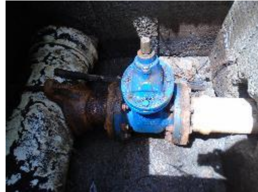
Fotografía 54. Válvula de Purga No 1
