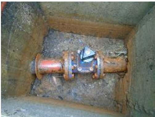
Fotografía 73. Válvula de Corte Ramal 2
