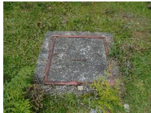
Fotografía 52. Válvula de Aire No 4
