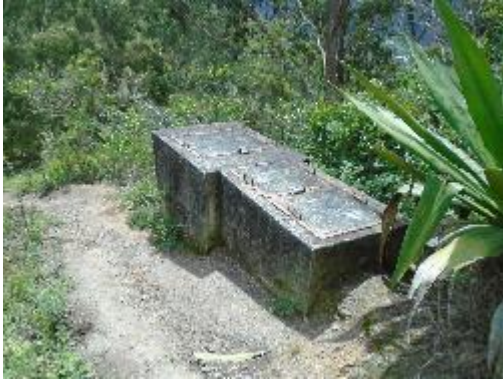
Fotografía 59. Cámara de Quiebre No 1
