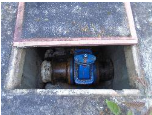
Fotografía 25. Cámara de la Válvula de Corte
