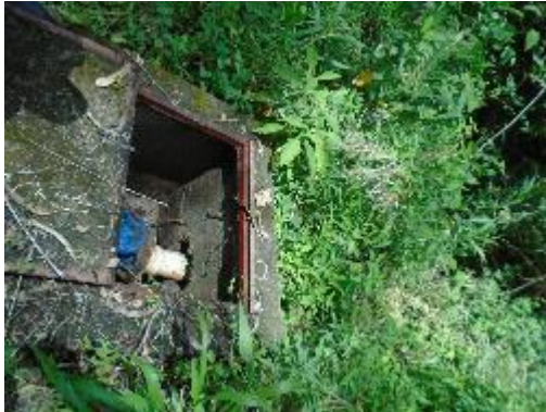
Fotografía 53. Válvula de Purga No 1
