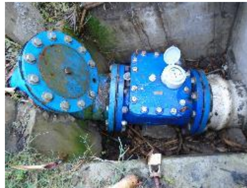
Fotografía 28. Valvulería Cámara Macro Medidor
