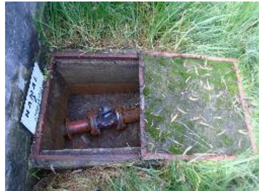
Fotografía 72. Válvula de Corte Ramal 2
