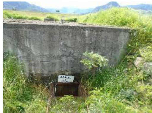
Fotografía 74. Válvula de Corte Ramal 2
