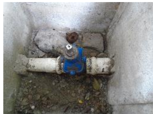
Fotografía 58. Válvula de Purga No 3
