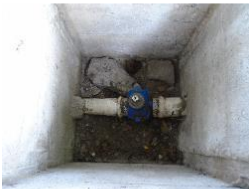
Fotografía 57. Válvula de Purga No 3
