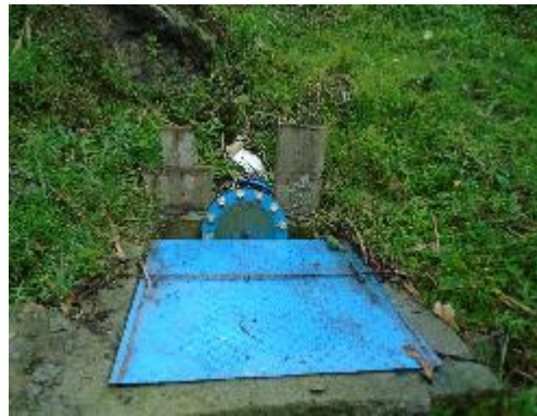
Fotografía 27. Cámara Macro Medidor
