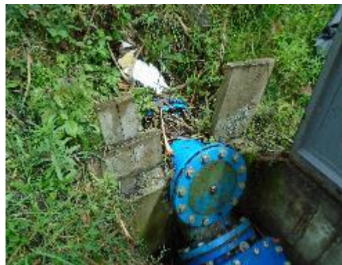
Fotografía 29. Filtro de la Cámara Macro Medidor
