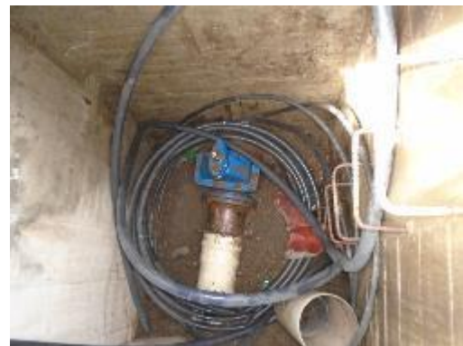
Fotografía 20. Válvula de Lavado
