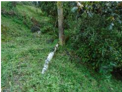
Fotografía 15. Tubería a nivel terreno
