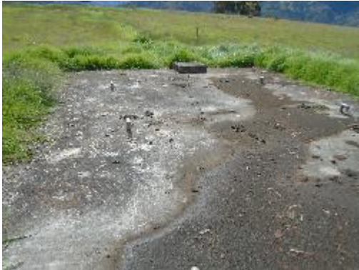
Fotografía 69. Tanque de repartición
