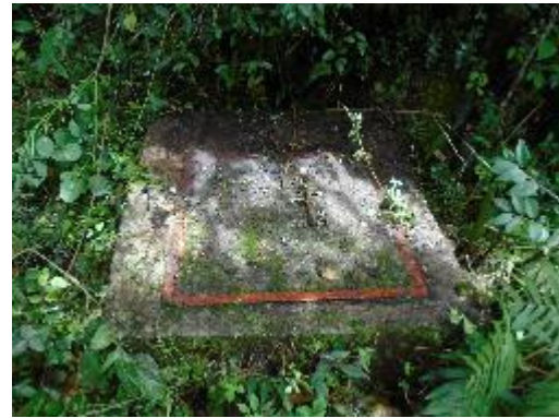
Fotografía 50. Válvula de Aire No 2
