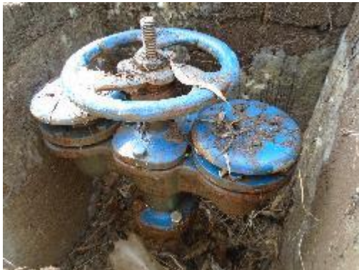
Fotografía 55. Válvula de Aire No 10
