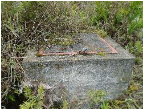
Fotografía 49. Válvula de Aire No 1
