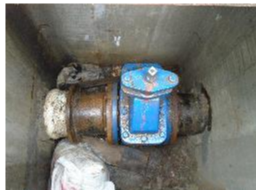
Fotografía 26. Válvula de Corte
