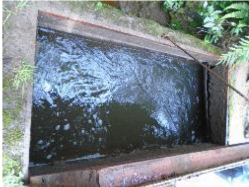
Fotografía 7. Cámara de Recolección
