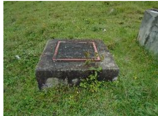
Fotografía 24. Cámara de la Válvula de Corte
