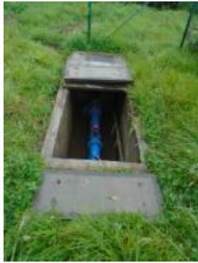
Fotografía 11. Sistema de Protección Macromedidor
