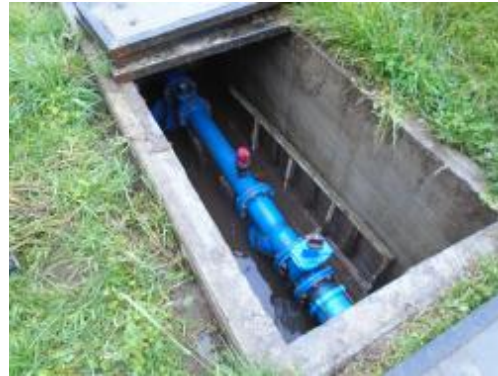
Fotografía 12. Valvulería sistema de Macromedición
