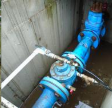
Fotografía 24. Cámara de válvulas C.Q
