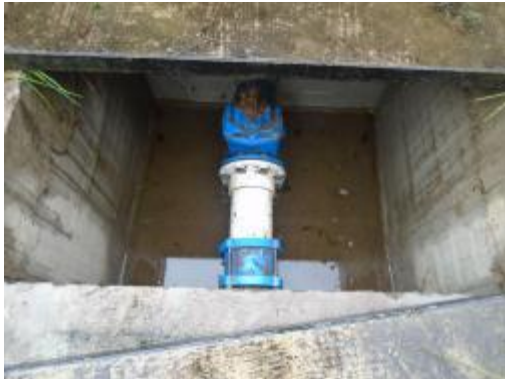
Fotografía 7. Válvula de Lavado
