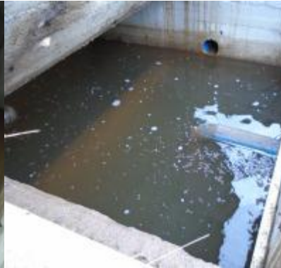
Fotografía 25. Cámara de Perdida de Presión C.Q
