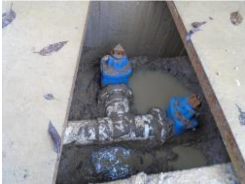
Fotografía 19. Purga de 6" N°2 y Corte 6" N°1 conducción
