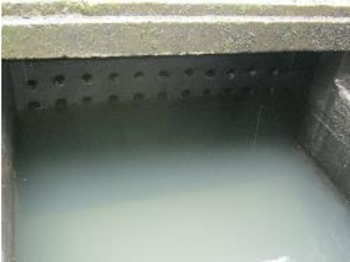
Fotografía 7. Pantalla Difusora del desarenador
