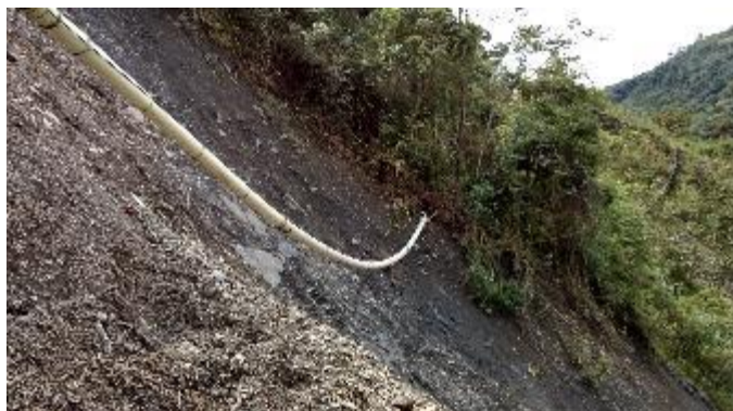
Fotografía 15. Tubería Anclada sobre nivel del suelo.
