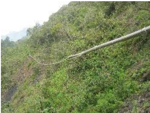
Fotografía 13. Tubería Anclada sobre nivel del suelo.
