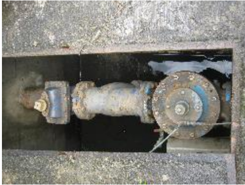
Fotografía 23. Cámara de Quiebre # 1
