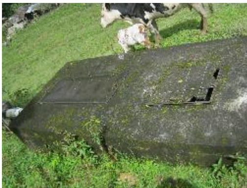
Fotografía 25. Cámara de Quiebre # 3
