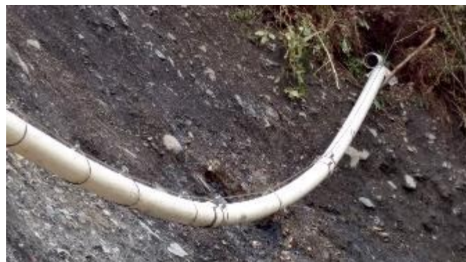
Fotografía 16. Tubería Anclada sobre nivel del suelo
