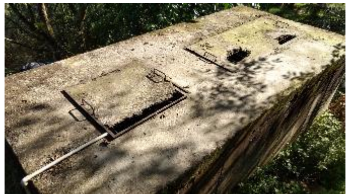
Fotografía 26. Cámara de Quiebre # 4
