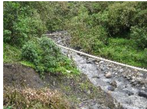
Fotografía 12. Tubería Anclada sobre nivel del suelo
