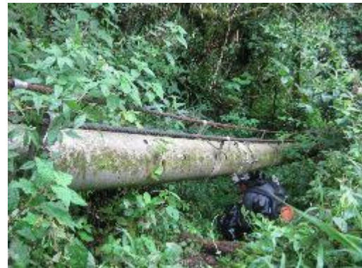
Fotografía 14. Tubería a Nivel del Suelo
