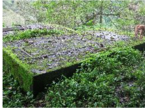
Fotografía 24. Cámara de Quiebre # 2
