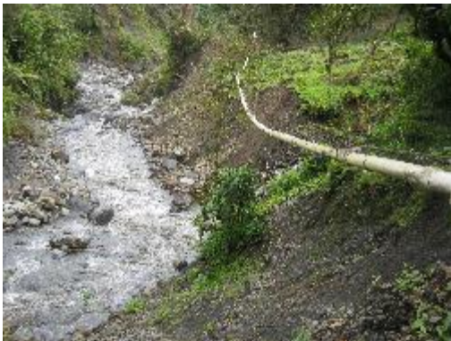
Fotografía 11. Tubería Anclada sobre nivel del suelo
