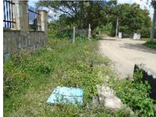
Fotografía 21. Vista Superior Válvula de Purga.
