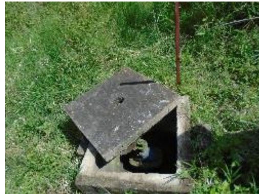
Fotografía 23. . Vista Lateral Válvula de Corte.
