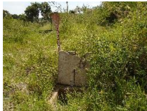
Fotografía 18. Vista Lateral Válvula de Aire.
