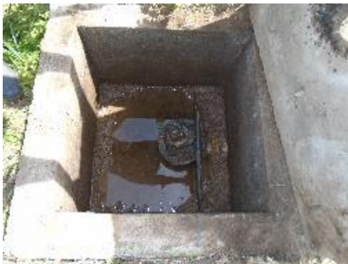
Fotografía 19. Vista Superior caja Válvula de Aire.
