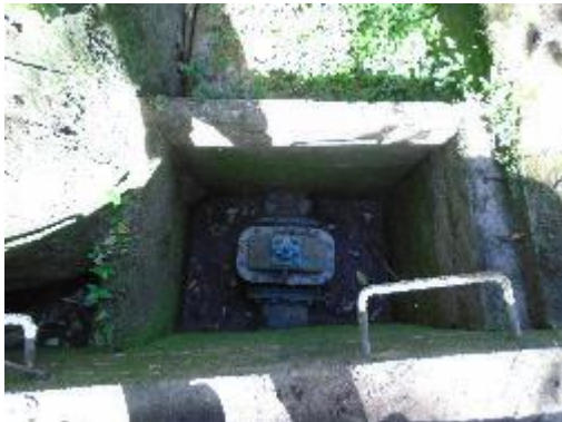
Fotografía 22. . Vista Superior Válvula de Corte.
