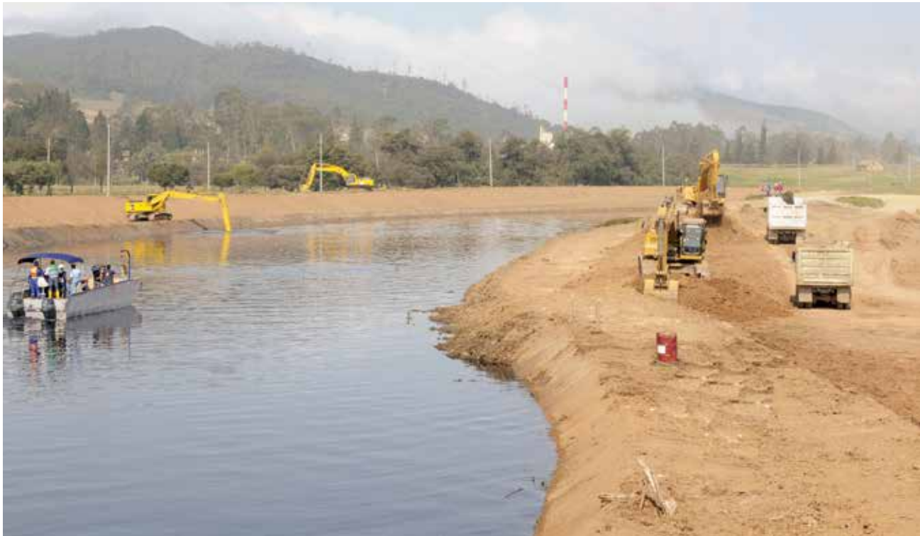
Adecuación hidráulica del Río Bogotá, Soacha - Fuente: Archivo fotográfico - Secretaría de Prensa y Comunicaciones, Gobernación de Cundinamarca
